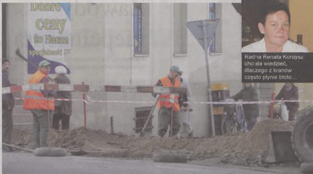
Awarie w dostawie wody są często efektem inwestycji i robót drogowych
