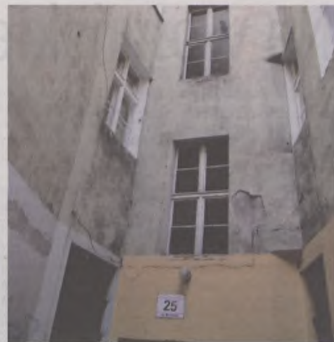
Okna na kłatkach są stare i nieszczelne
