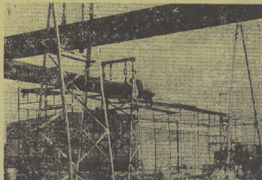
Fragment instalacji nowej ciepłowni, która jeszcze niedawno miała trudności ze skompletowaniem załogi.
