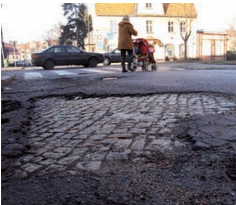
Drogi w Jeleniej Górze przypominają szwajcarski ser.
