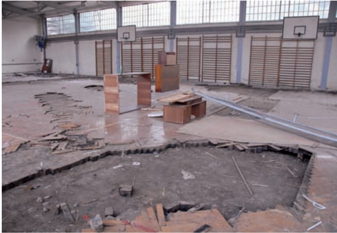
Nowy irlandzki właściciel powojennego obiektu dopuścił do jego dewastacji. Mieszkańcy boją się, że otwarta, niebezpieczna hala stanie się miejscem zabaw dzieci.
