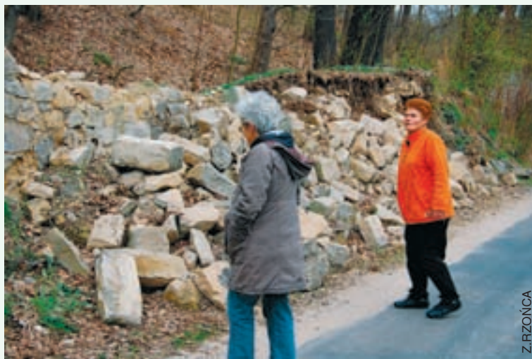
Część muru już się zawaliła...
