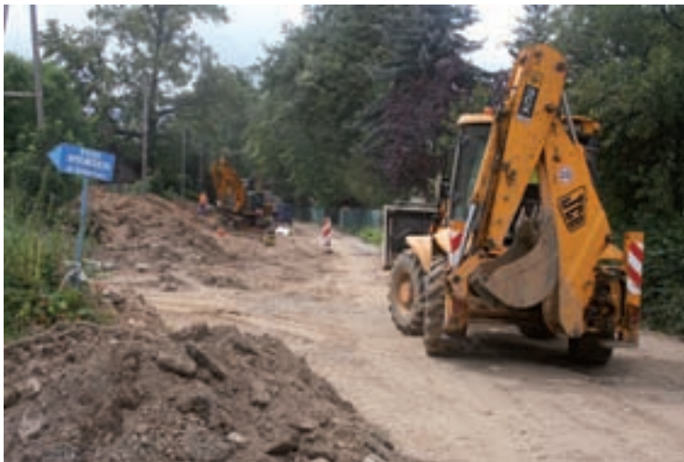
Tak wygląda dojazd do pensjonatów przy Kolorowej. Można uszkodzić zawieszenie.
