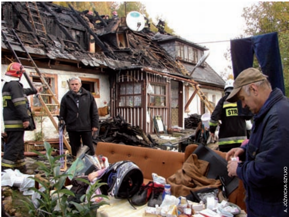
Powrót państwa Purzyńskich do spalonego domu jest, póki co, niemożliwy, zabronił tego inspektor nadzoru budowlanego.
