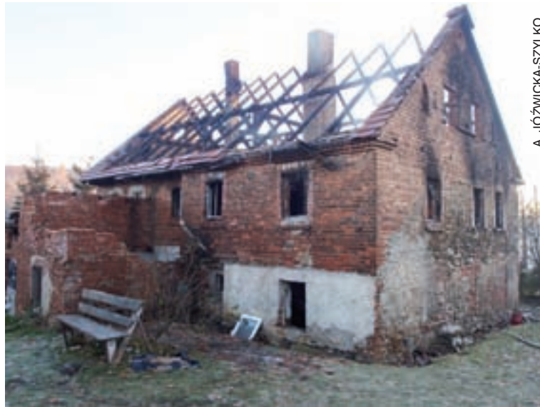
Dom nie nadaje się do odbudowy. Będzie rozebrany.
