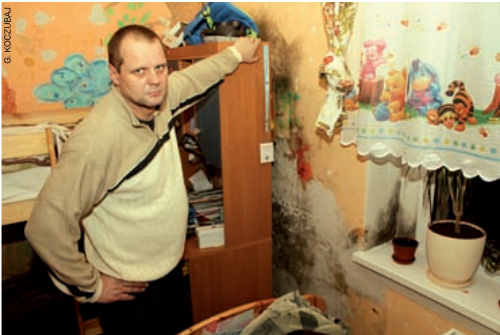
- Przecież wietrzymy mieszkanie, ale grzyb siedzi głęboko w murach - mówi Sebastian Kotylak.
