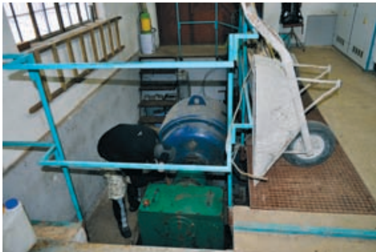
Najlepiej stan łożysk w generatorze sprawdzić na słuch.
