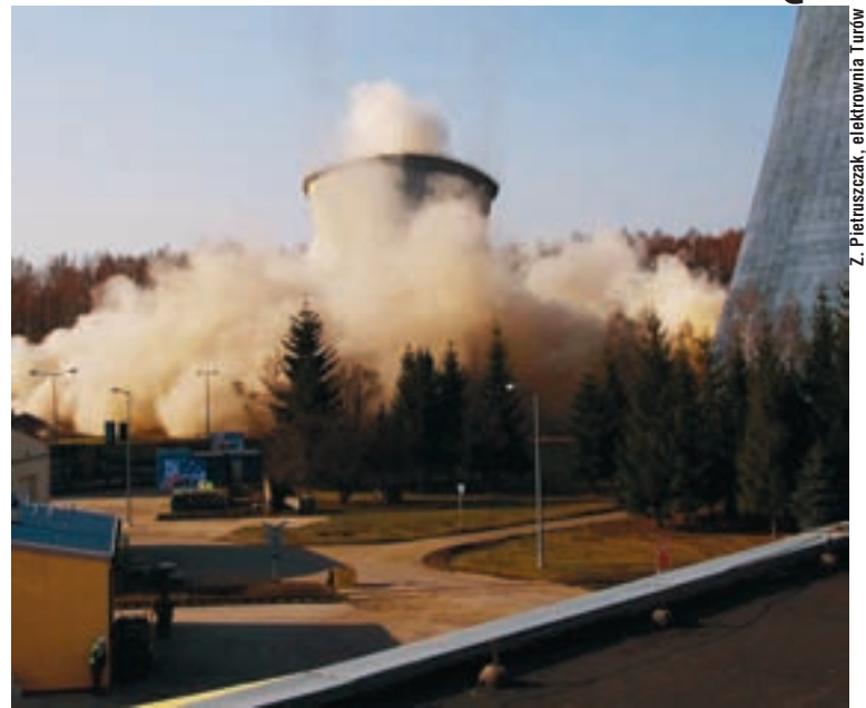
Z. Pietruszczak, elektrownia Turów
