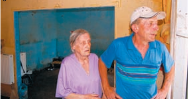
W tym domu woda sięgnęła sufitu. Na zdjęciu widoczny ślad nad głowami domowników.
