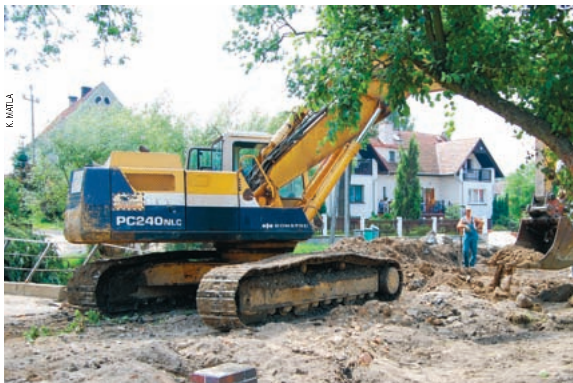
Najbardziej zniszczona ulica w Olszynie - Żymierskiego. Musi być odbudowana, bo ludzie stracili możliwość dojazdu do domów.
