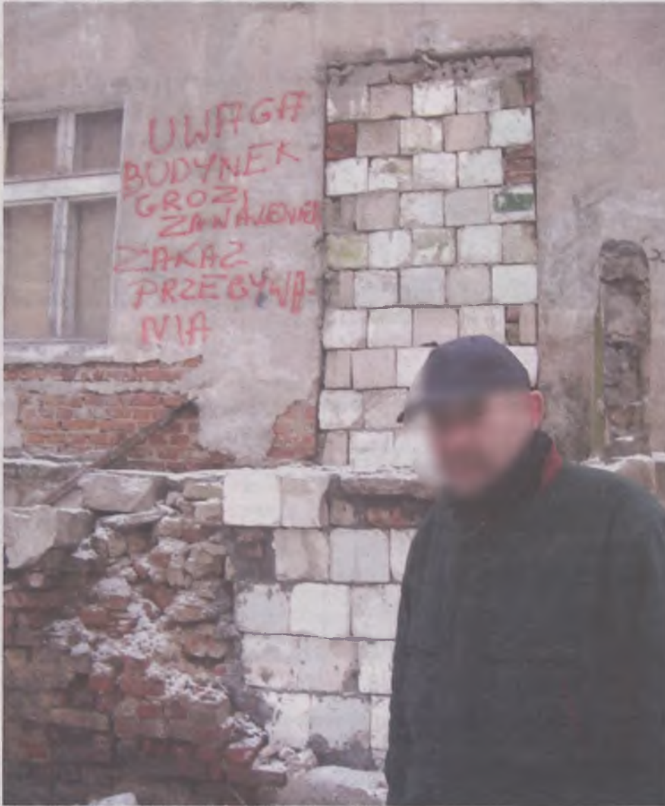
Wejście do domu, w którym mieszkał Tadeusz zamurowano
