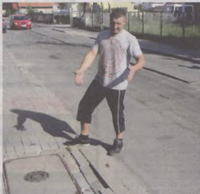
- Samochody, omijając, dziury jeżdżą po chodniku i niszczą studzienki kanalizacyjne - mówi mieszkaniec ul. Spółdzielczej Piotr Jabłoński
