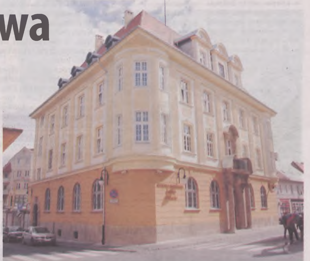
Budynek oławskiej policji już nie straszy odpadającym tynkiem
