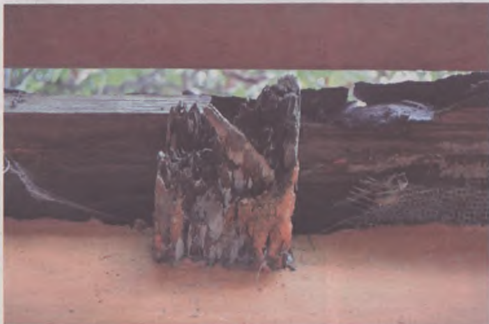
Budynek remizy jest w katastrofalnym stanie. Tak wyglądają krokwie dachowe
