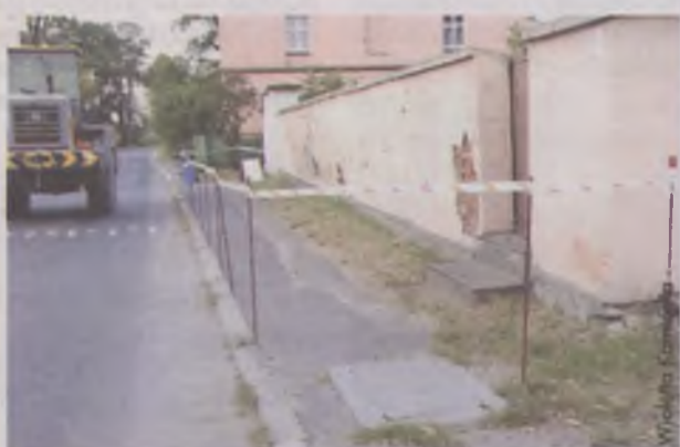
Ogrodzili walący się mur, by zapobiec nieszczęściu. A co z bezpieczeństwem przechodniów?
