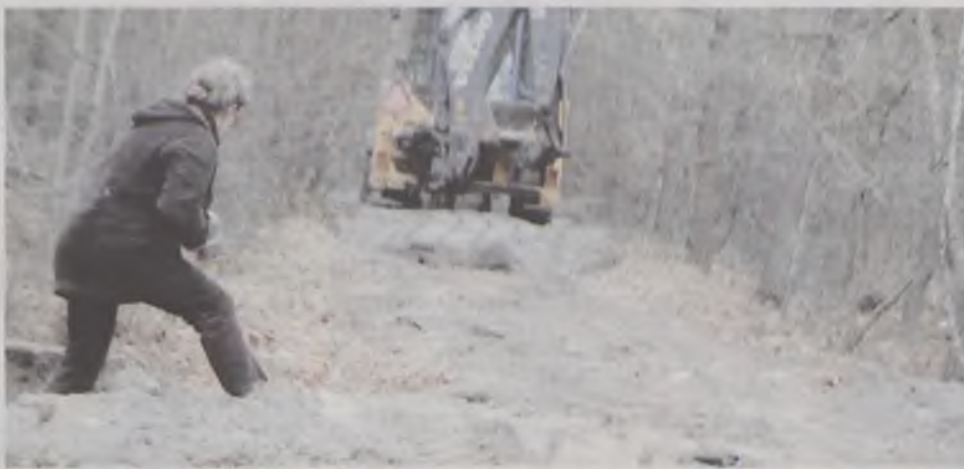
Zgodnie z obietnicą nadleśnictwo odbudowuje drogę w lesie, która stanowi przedłużenie wału przeciwpowodziowego. Radna Bogusława Kutkowska (na fot.) pokazuje, że w nawożonej ziemi są kawałki gruzu, których być nie powinno
