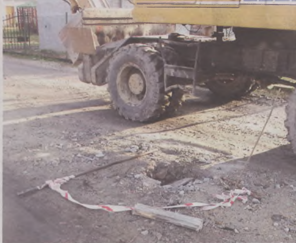
Na Spółdzielczej straszy zapadnięta studzienka
