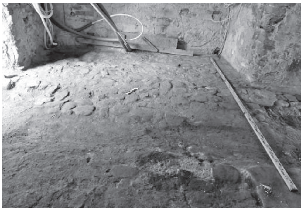
Ryc. 10. Rynna w środkowej części korytarza (fot. 2013 r.).
