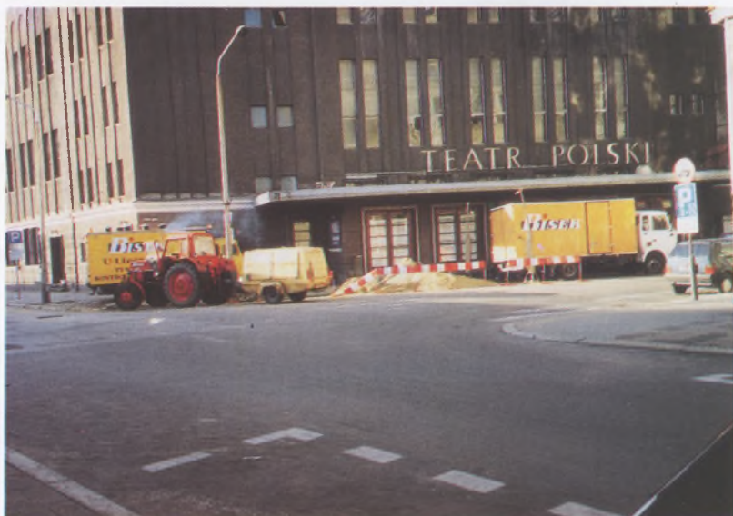
Usuwanie awarii wodociągu Dn 300 pod budynkiem Teatru Polskiego, rok 1994.
