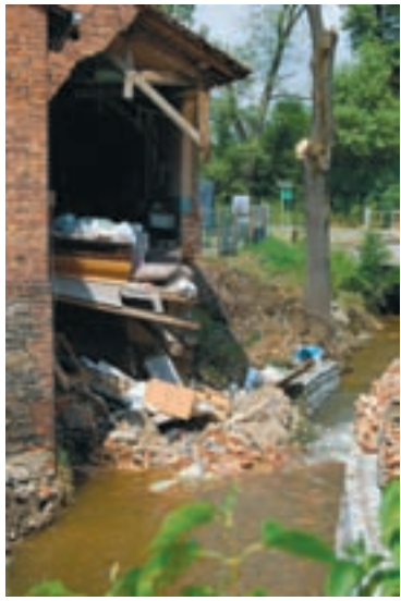
Narożnik domu w Stankowicach zsunął się do rwącego potoku. Całe szczęście - nie ucierpiał nikt z ludzi.
