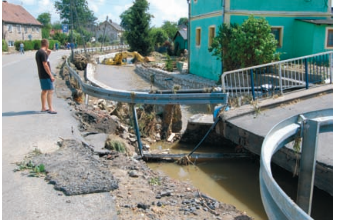
Główna ulica w Olszynie. Rzeka Olszówka zerwała świeżo wyremontowany most i zdewastowała brzozy koryta. W tle koparka leżąca w poprzek nurtu.
