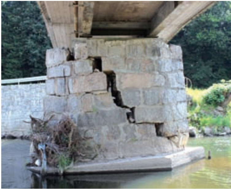
Filar mostu wygląda, jakby lada chwila miał runąć do wody.
