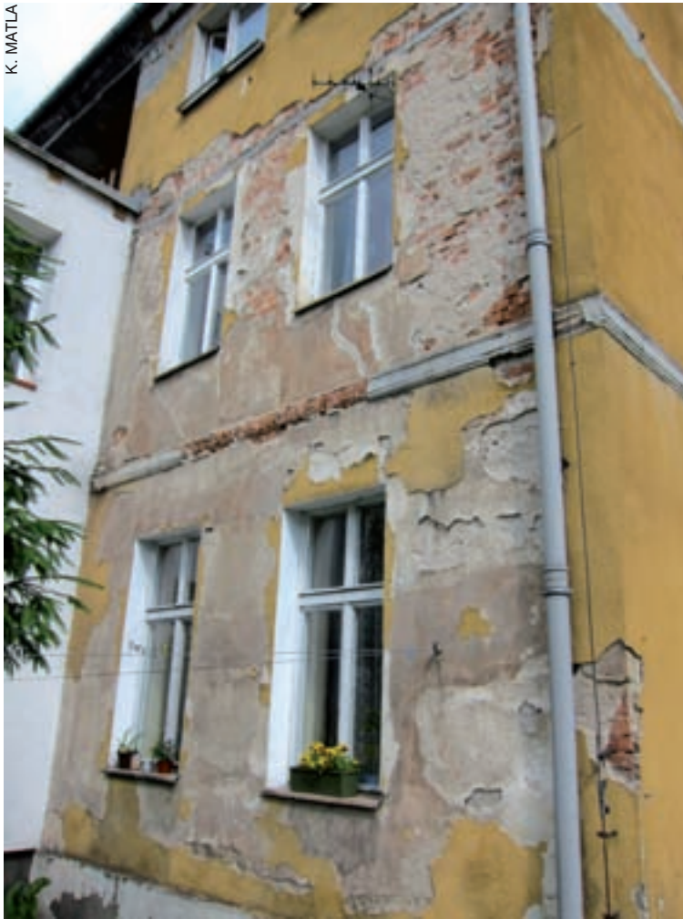
Pani Ewa Zalewska, mieszkanka kamienicy przy ul. Cieplickiej 60, od 6 lat zabiega, żeby poprawić to, co sfuszerowano podczas remontu w 2007 r. Przez tamto brakoróbstwo zalewa jej mieszkanie, a kamienica wygląda, że pozał się Boże.
