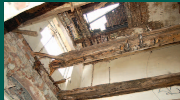
W niektórych miejscach z dawnych podłóg pozostały tylko spróchniałe belki
