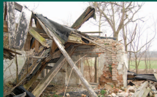
Przebywanie w młynie jest niebezpieczne - część budynku już się zawaliła
