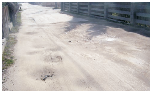
Wgłębienia i garby - Spółdzielcza wygląda tak od miesiąca. Może zamiast tymczasowego poprawiania przejezdności, gmina wreszcie zrobiłaby tę drogę?
