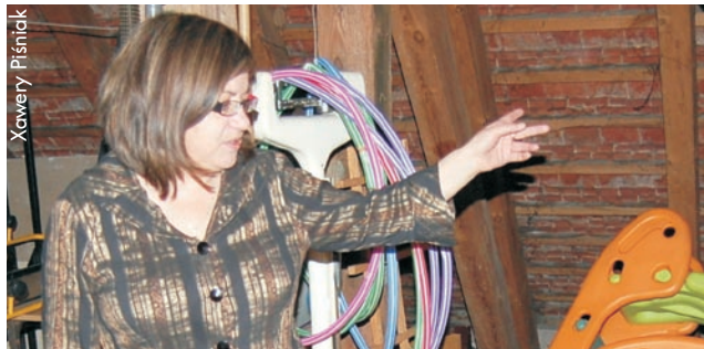
Dyrektor Boruń cieszy się, że połatany i przeciekający dach będzie odnowiony
