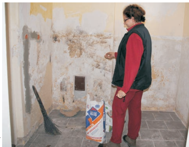
Zniszczony podczas powodzi budynek wymagał dużego nakładu pracy. - W pierwszej kolejności trzeba było zbić ze ścian stary tynk - mówi Bogusława Kutkowska
