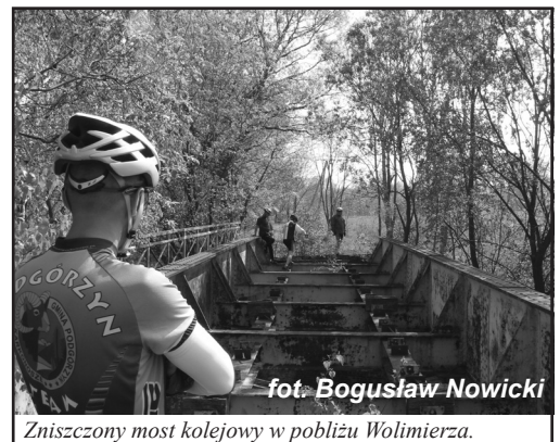
Zniszczony most kolejowy w pobliżu Wolimierza.
