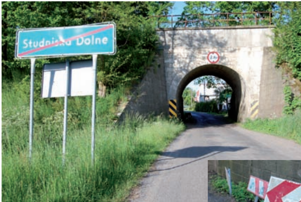
Pod wiaduktem kolejowym straszy dziura, do której nikt się nie chce przyznać.
