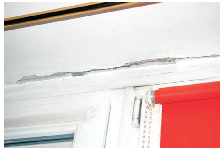
To uszkodzenia w mieszkaniu Badury
