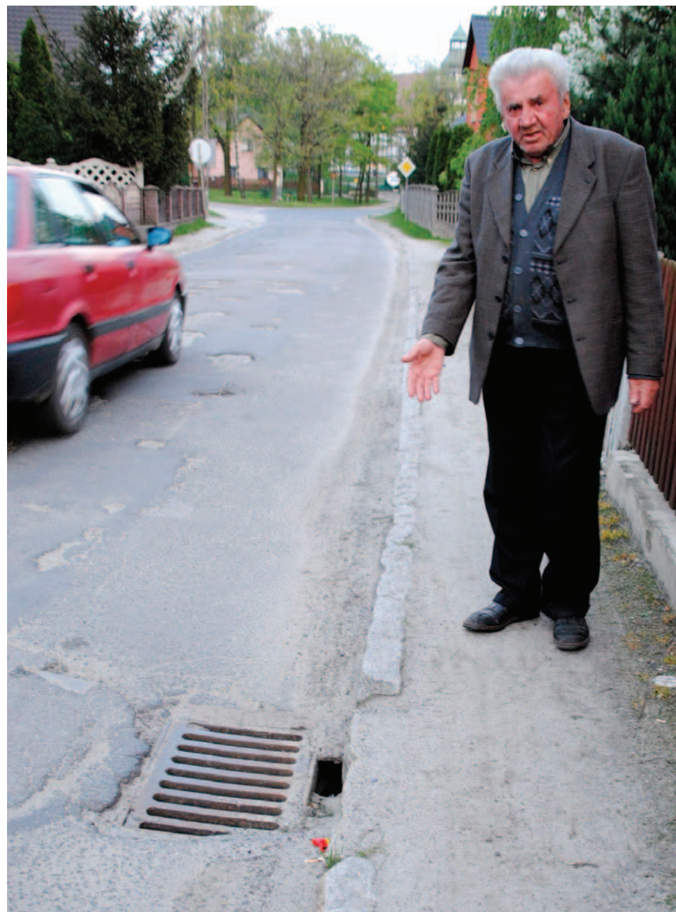
Kratka ściekowa obok domu Michała Wysoczańskiego i rozjeżdżone przez samochody krawężniki oraz pobocze
