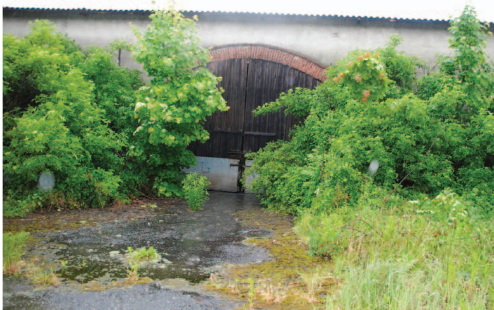
Budynki gospodarcze, które przejęła ANR, zarastają chaszczami
