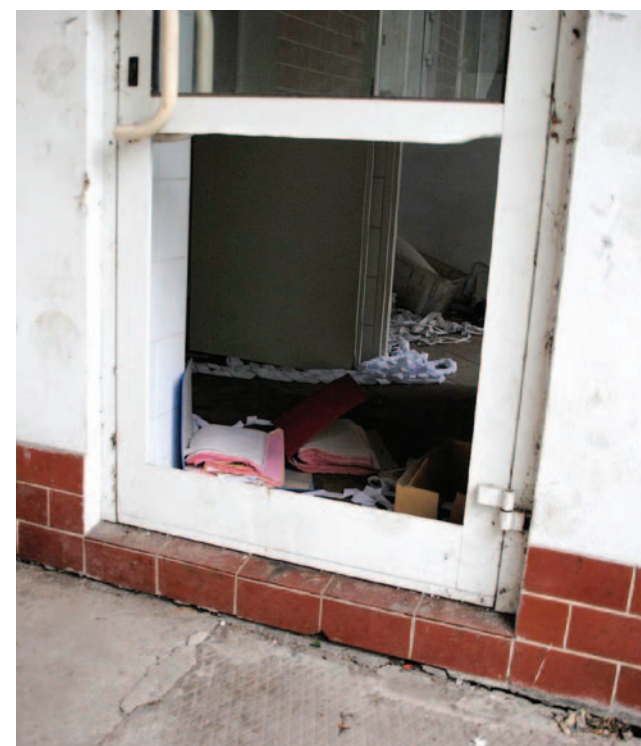
W drzwiach do budynku dawnego zakładu mięsnego nie ma szyby. W środku jest mnóstwo dokumentów i faktur, które poniewierają się także na posesji
