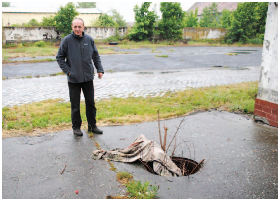
- Tak wyglądał jeden z wlotów do szamba, znajdującego się tuż przy ulicy, którą codziennie chodzą dzieci - mówi sołtys Polwicy Piotr Kożak. - Takich miejsc jest więcej
