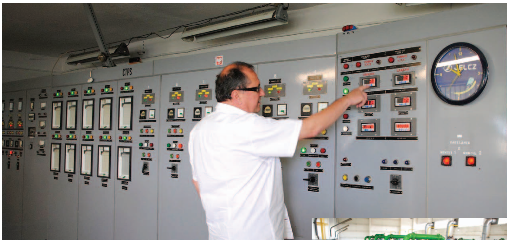
Paweł Jankowski pokazuje obecną dyspozytornię Stacji Uzdatniania Wody w Piekarach. Po modernizacji starą szafę zastąpi komputer i ogromny monitor
