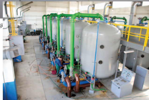
Filtrowanie wody na stacji uzdatniania. Po przebudowie stacji będzie się to odbywało elektronicznie
