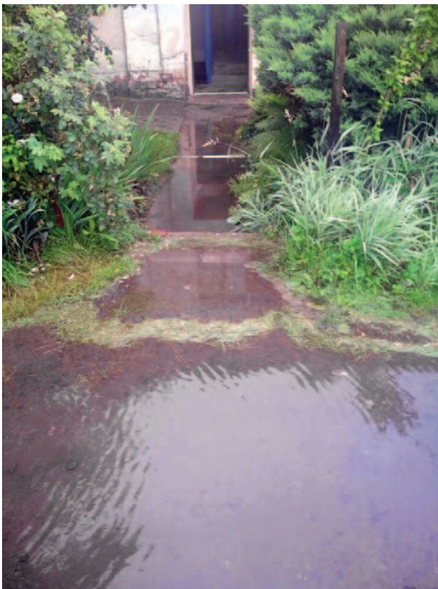
Woda z drogi płynie do klatki schodowej i do piwnicy
