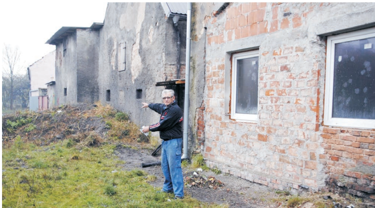
Ziemia, która pozostała po budowie kanalizacji, niszczy budynek Jana Kowalskiego
