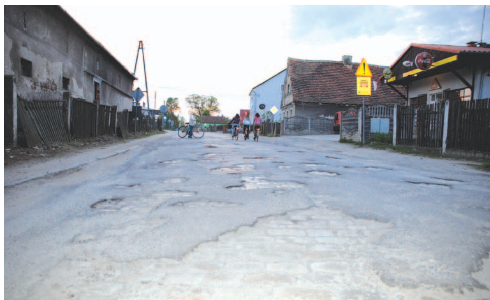
Tak dziś wygląda droga powiatowa nr 1549 w Bystrzycy
