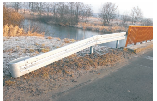
Nowe barierki już są, ale tylko przy jednym stawie i - niestety - nie na całej długości mostu. Zabezpieczają jedynie boki
