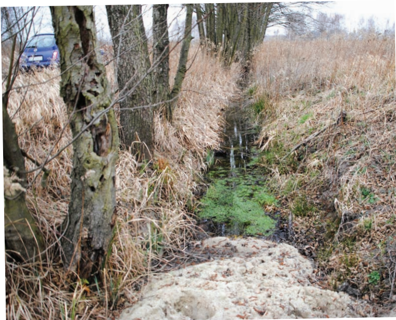
Rów od nowo wybudowanego odcinka wału do ul. Lipowej jest prawie zarośnięty. Trudno uwierzyć, że przynajmniej raz był czyszczony w ciągu kilku ostatnich lat
