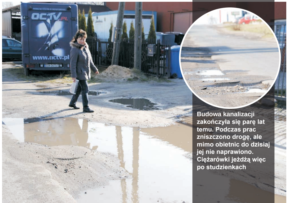
Tak wygląda wjazd na posesję Krystyny Chrzanowskiej: - Kostka jest do granicy mojej działki, dalej - nawet gdybym chciała - nic nie mogę zrobić, bo to nie mój teren
