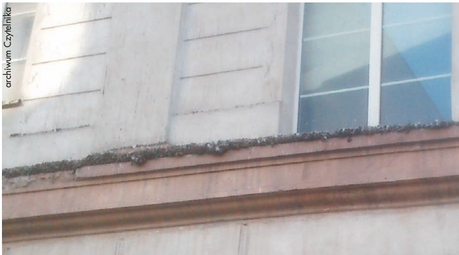
Gruba warstwa ptasich odchodów rzuca się w oczy
