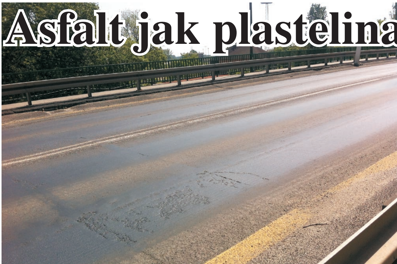
Część nawierzchni zjechała z mostu na kołach samochodów
