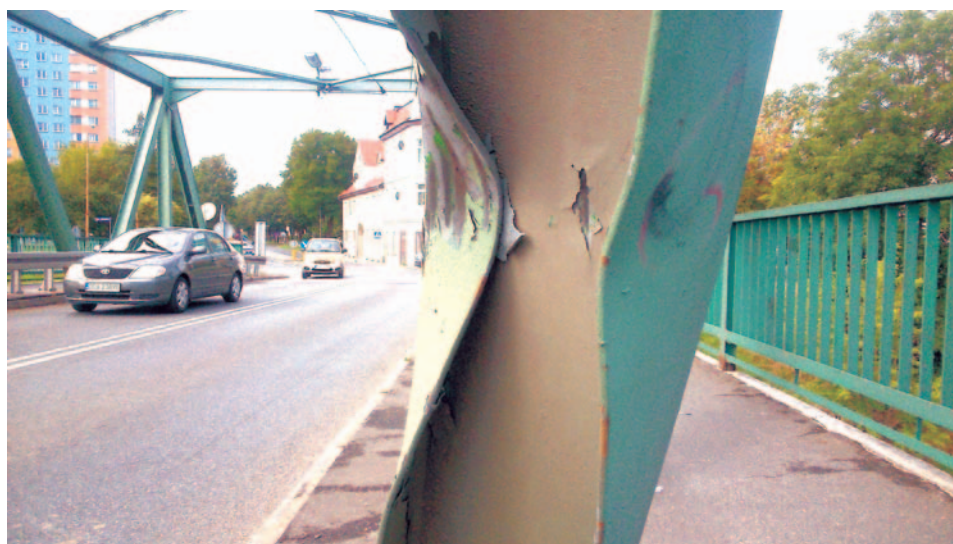
Tak wyglądają uszkodzenia (Z archiwum)
