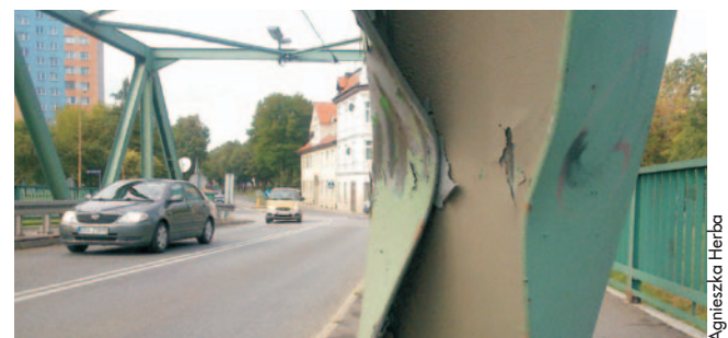
Uszkodzone przęsło mostu
