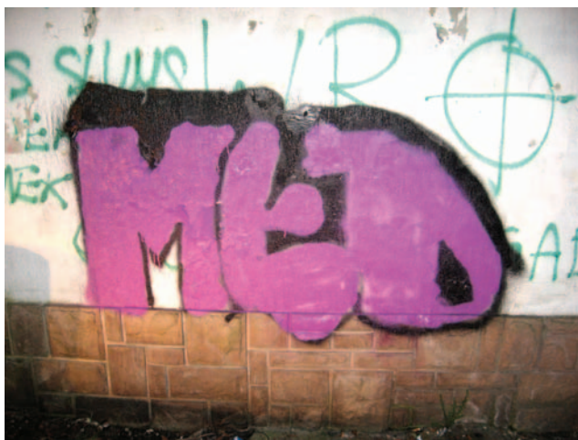
„Dzieło” z ulicy św. Rocha. Właściciel budynku wycenił szkodę na 1300 złotych
