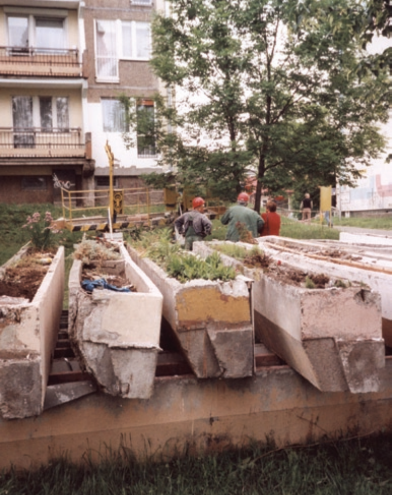
Słynne „koryta balkonowe” tak bardzo zwiększające zużycie materiałów budowlanych (wówczas deficytowych) od początku były też kłopotliwe dla mieszkańców. Ich zdemontowanie przy okazji dociepleń lokatorów przyjęli z ulgą, a domy z innymi, lżejszymi balkonami, znacznie zyskały na wyglądzie
