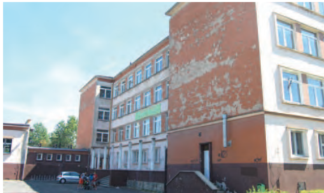
Sanepid wskazuje na potrzebę naprawy schodów w SP nr 2
