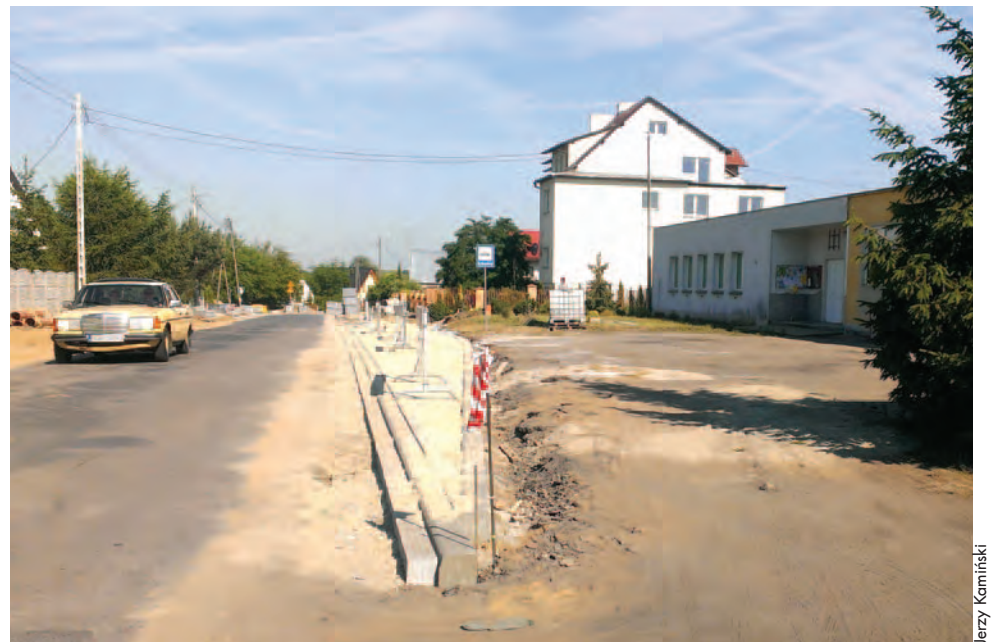
Budowlancy trochę się rozpędzili z tymi krawężnikami
