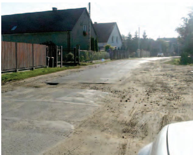
Tak wygląda droga po budowie kanalizacji w Sobocisku
