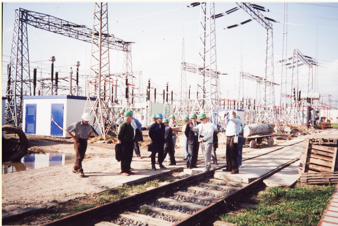
Stacja rozdzielczo-transformatorowa WN 400/220/110 kV Mikułowa, 2001 r., fot 1.
