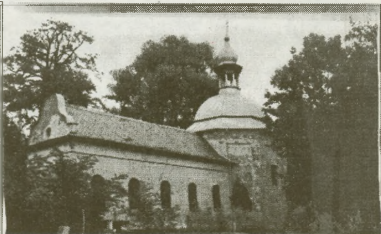
Pozbawiona elewacji Kaplica Św. Jadwigi najprawdopodobniej przetrwa tę zimę, ale czy następną...?
