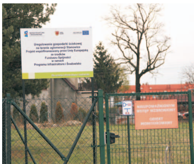
Przepompownia ścieków w Marcinkowicach
