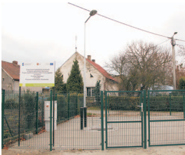
Przepompownia ścieków w Jankowicach
