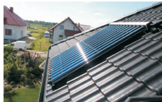
Dotacja może być m.in. wykorzystana na dofinansowanie zakupu i montażu kolektorów słonecznych, służących do ogrzewania domu jednorodzinnego
